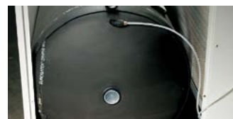
Serbatoio di accumulo ad alta capacità.
